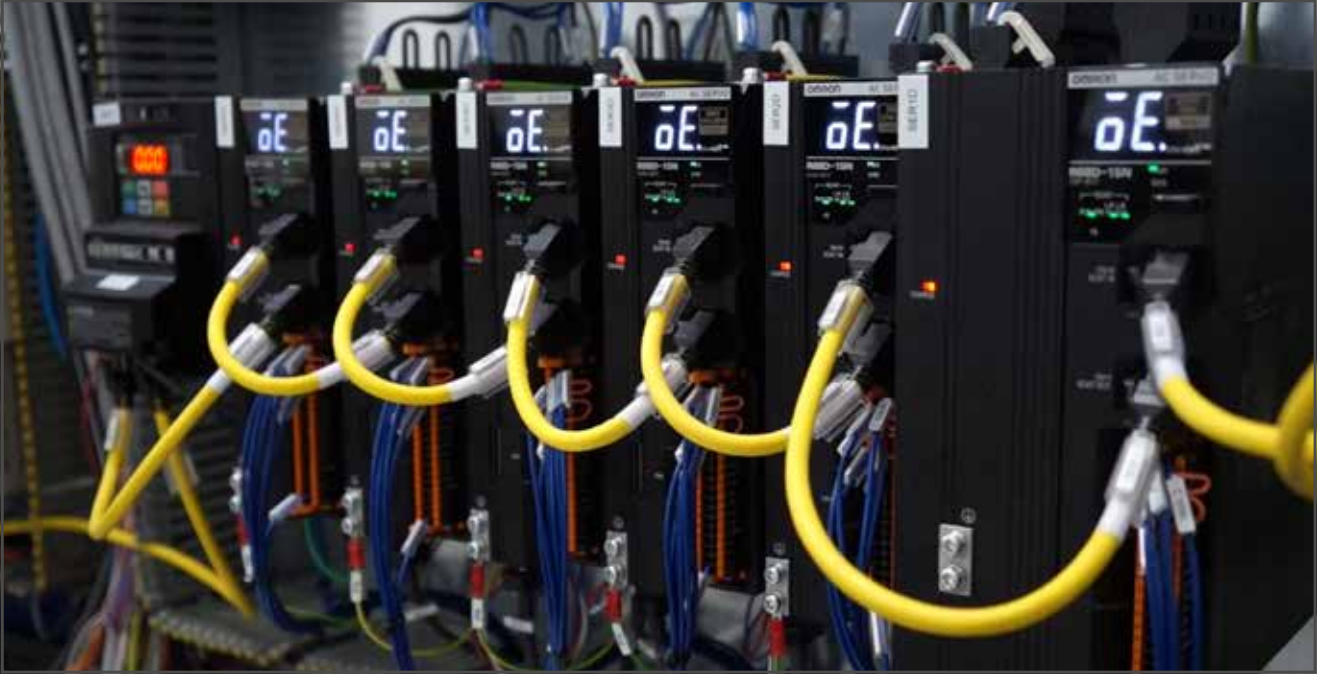
OMRON kontrolörü, 34 adet OMRON 1S servoyu ve altı adet 3G3MX2 inverteri yönetir.
