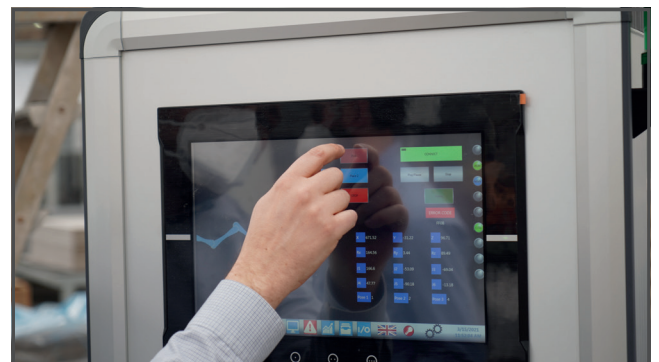
Tutti i dati vengono inviati e gestiti centralmente da un PLC OMRON NX102 collegato al MES.
