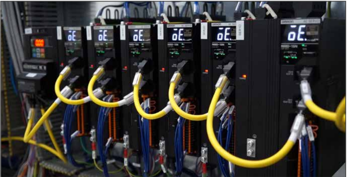
Der Controller von OMRON steuert 34 OMRON 1S-Servoantriebe und sechs 3G3MX2-Frequenzumrichter.
