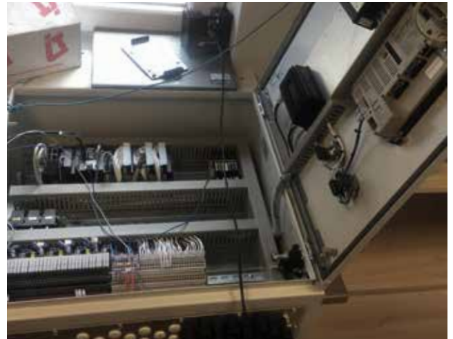
De nye, mindre Omron Value Design-tavleprodukter kan nu også monteres ved siden af hinanden takket være reduceret strømforbrug. Dette gør det muligt at holde samme tavlestørrelse, men frigør plads til Sysmac-plattformen.
