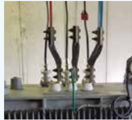
Trafonun anormal şekilde ısınması
