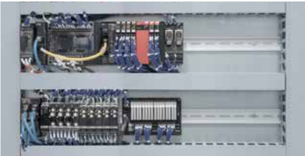
Oszczędność miejsca i bardziej zaawansowane szafy sterownicze.....str. 6
