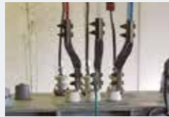
Calentamiento anómalo de los transformadores debido al aumento de la temperatura ambiente
