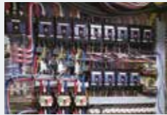
Sobrecalentamiento de los dispositivos causado por el aumento de las temperaturas dentro del cuadro
