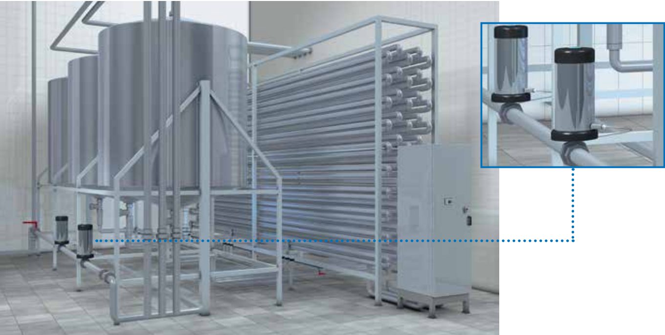
Kontroluje polohu ventilů v míchačích nebo topných systémech.
